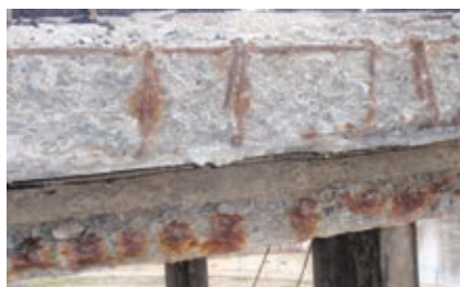
Рис. 1. Разрушение торцов тротуарных блоков путепровода
