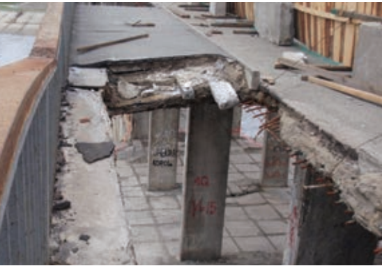
Рис. 3. Коррозия арматуры и разрушения защитного слоя бетона опоры путепровода
