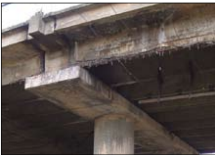
Разрушительное действие воды. Видно выщелачивание бетона от разрушения деформационного шва на проезжей части
